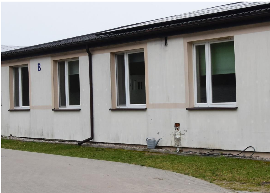
Ryc. 7. Widoczne ubytki w elewacji budynku „B” Centrum Medycznego Zdrowie Kraszewo-Czubaki
