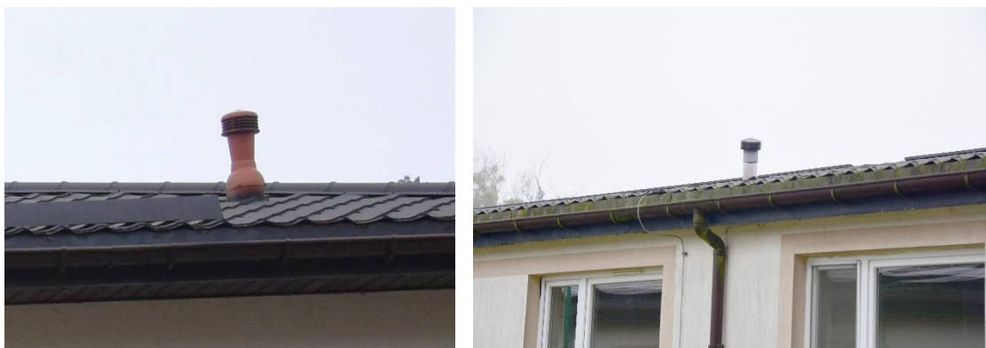
Ryc. 22-23. Kominki wentylacyjne budynków Centrum Medycznego Zdrowie
